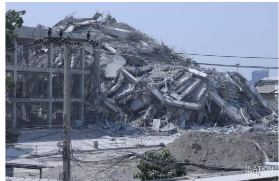
(c) Công trình sau khi sụp đổ
